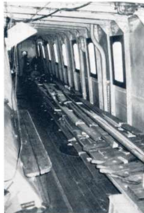
Däcksplankorna från fördäck ligger prydligt uppstaplade på mellandäck i avvaktan på att underarbetena på fördäck skall bli klara.
