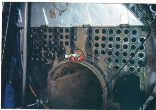
Sotskäpsändan av ångpannan i FÄRJAN 4 med alla tuberna monterade. Foto Gunnar Söderberg 15 oktober 2001
