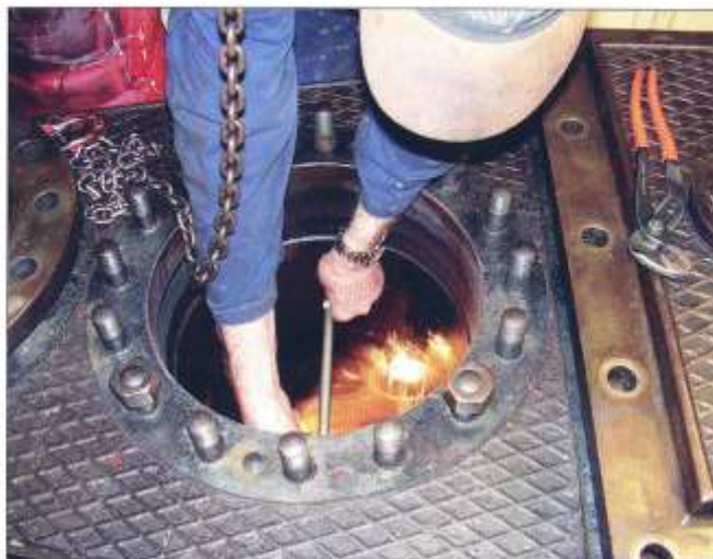
Här kontrollmäter Mats Demker högtryckscylindern invändigt. Foto Walter Fogelström
