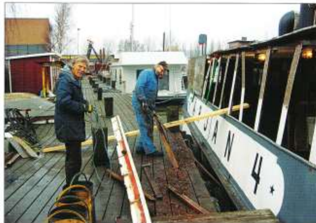
Mellan Rolf Nilsson till vänster och Bert Johansson ligger den nya bortsåarna ena halvan av stringerplåten från takkanten. Mycket arbete återstår ännu innan färjans överbyggnadsida är återställd. Foto Gunnar Söderberg 6 december 2008.
