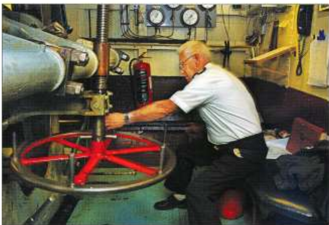
Maschinen i SKIBLADNER slår manövrer vid trippelångmaskinen. Vid 42 varv per minut gör ångaren 12 knop. Kållboxarna släpper maskintrummet från pannrummet där också dieselgeneratoren står. Foto Brynjør Eidsvold
