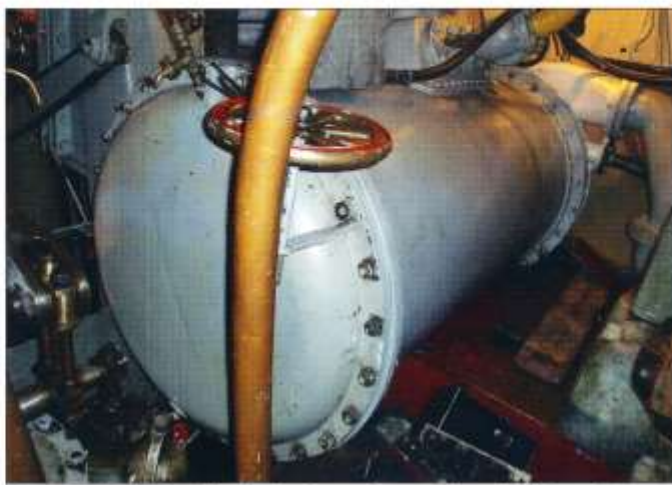
På ångmaskinens babordssida sitter kondensorn. Det är en liggande cylinder med en massa rör (tuber) i vilka sjövattnet strömmar igenom. När ångan lämnar ångmaskinen kyls den till vatten i kondensorn för att kunna återmatas till pannan. Foto Ingvar Kronhamn
