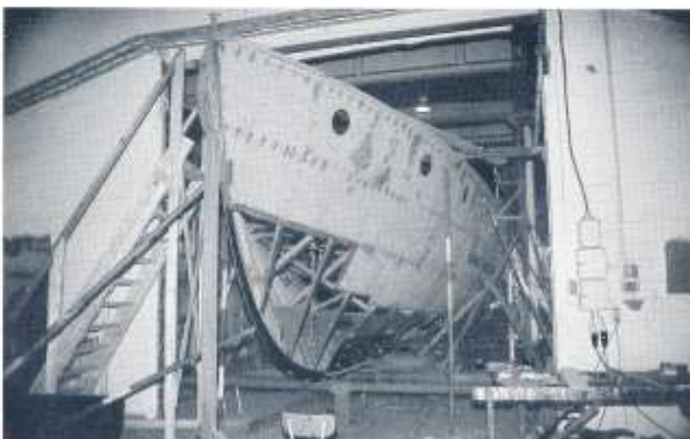
FREJAs förstäv sticker ut ur hallen i Sunne. Plåtbyte pågår. Foto i Sunne; Bo Starmark.
